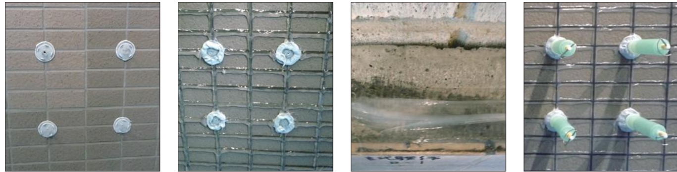
穿孔・JP台座セット ピックアップシールクリアー打設 供試体断面シール IPHカプセル設置・樹脂注入
