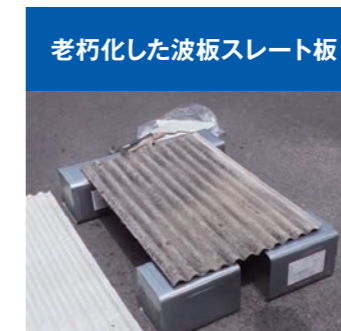
老朽化した波板スレート板 両足が乗った直後に破損
