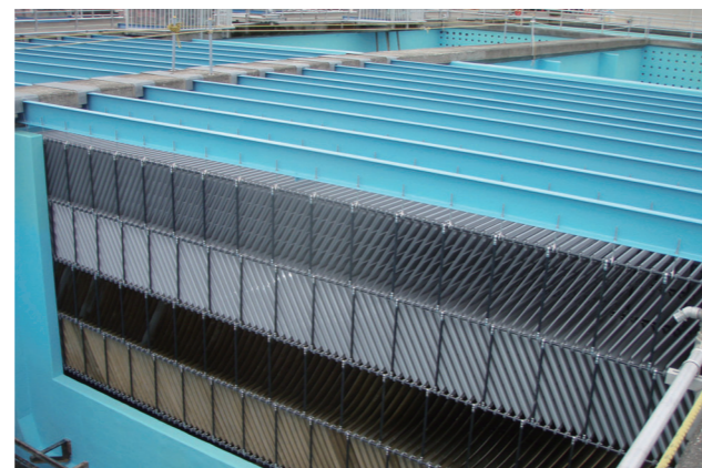
上水施設(着水井、沈澱池)
